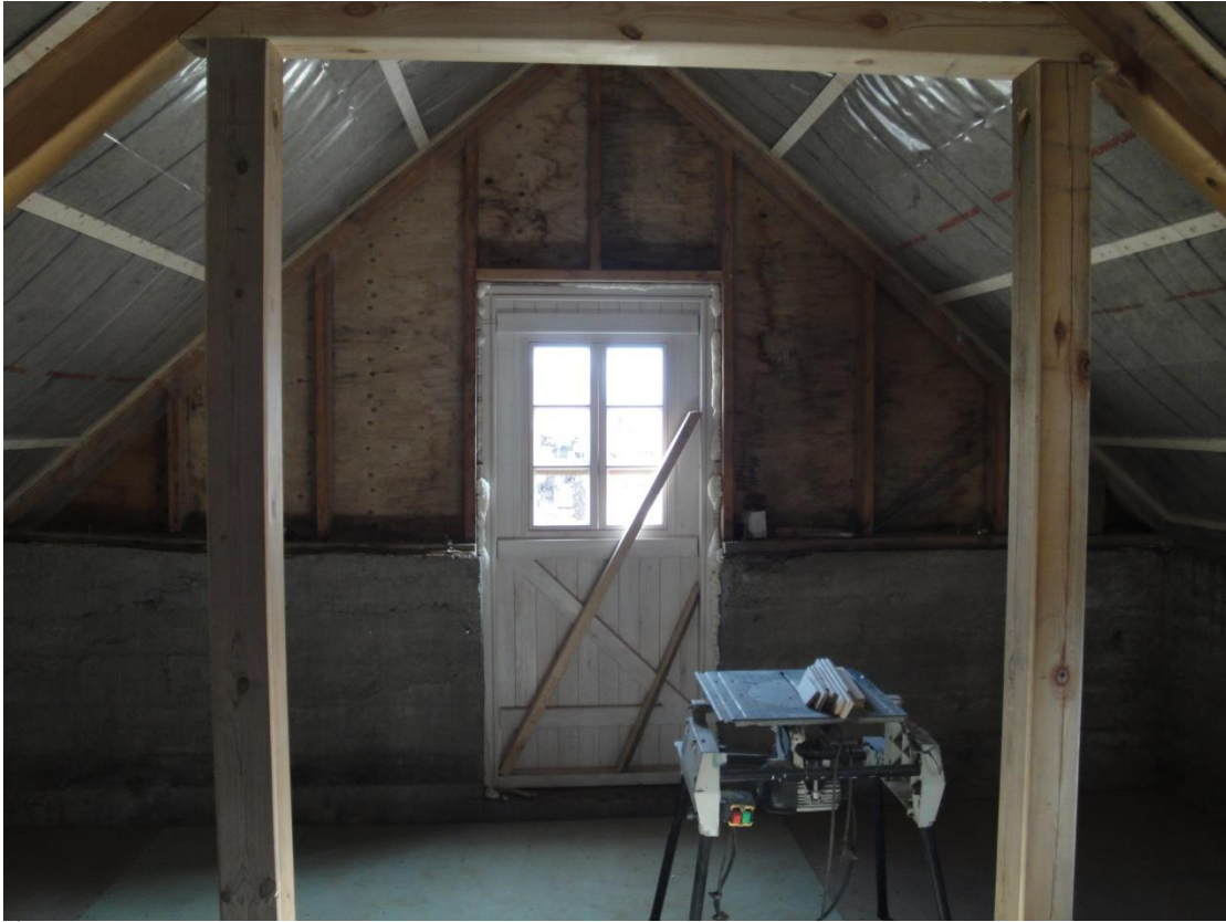
Óbyggðasafn. Flóttaleið úr norðurgafli.
